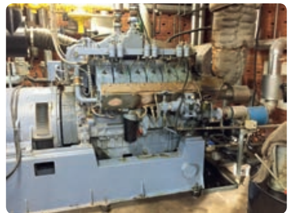
Auf dem Bauernhof von Georgs Vater erzeugt ein Generator aus Biogas Strom. Den kann der Bauer an Stromkonzerne verkaufen.
