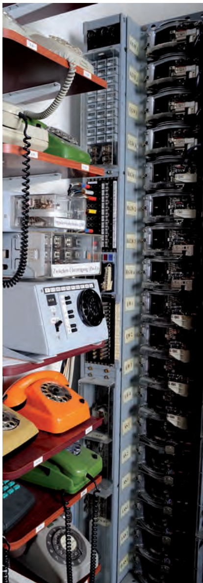
Oben eine EMD-Vermittlungsstelle von Siemens aus den 1950er Jahren neben Wählscheibentelefonen.
