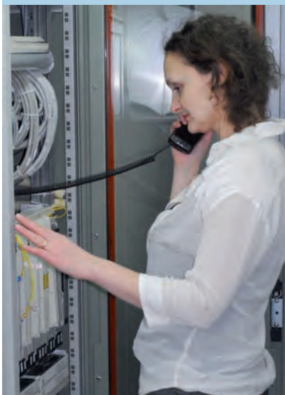
Mobile Vermittlungsstellen (MSC) sind die Koordinations- und Steuerzentralen der mobilen Kommunikation. Sie organisieren sekundenschnell den Aufbau der Verbindung durch die Kabel des Festnetzes bis zu der Funkzelle, in der sich der Angerufene befindet.
