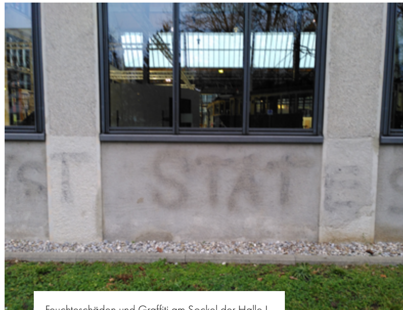
Feuchteschäden und Graffiti am Sockel der Halle I.
