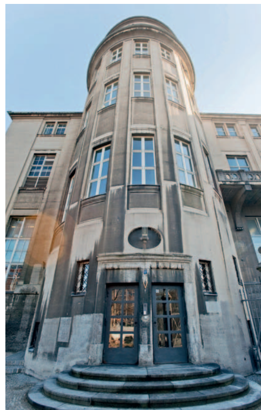
Fassadensanierung: Hier ein Ausschnitt im Zustand vor der Sanierung Anfang 2010. Der Zustand nach der Sanierung ist auf S. 117 zu sehen.
